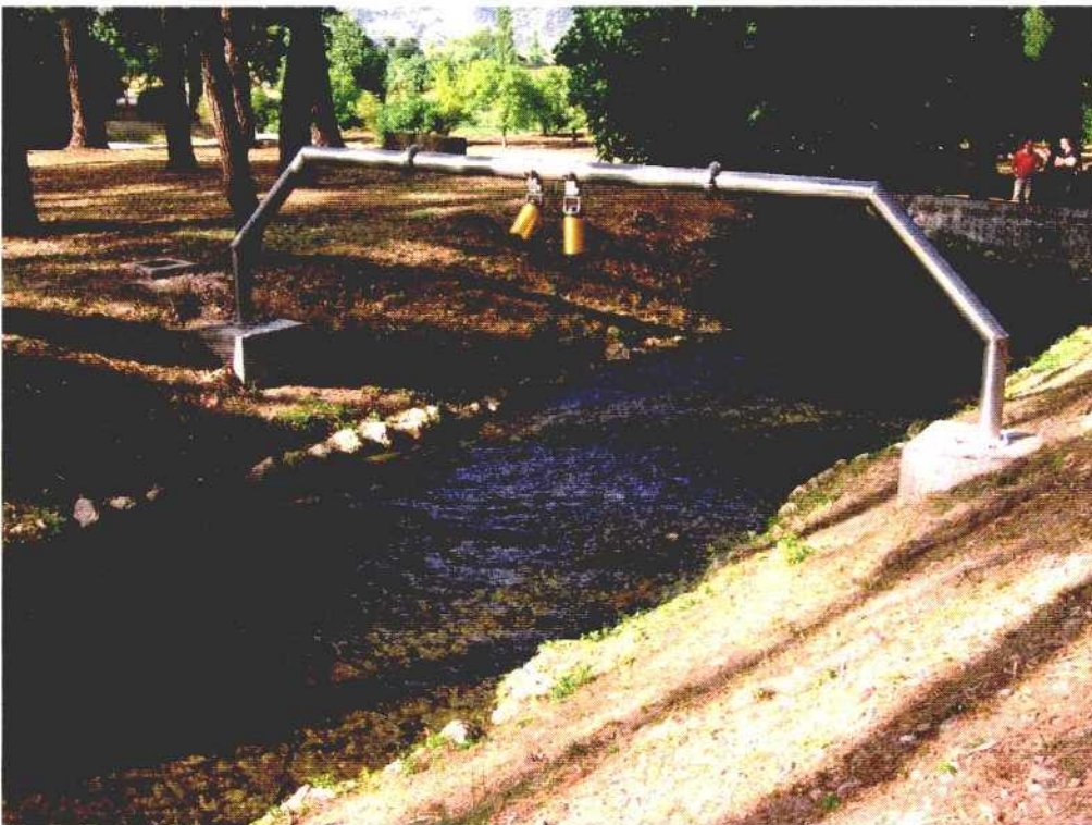
PÓRTICO TUBULAR DE ACERO INOXIDABLE CON DE RADARES DE NIVEL Y VELOCIDAD DEL AGUA
