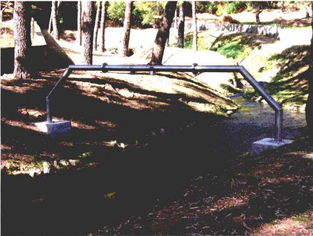
PÓRTICO TUBULAR DE ACERO INOXIDABLE PARA SOPORTE DE RADARES DE NIVEL Y VELOCIDAD DEL AGUA
